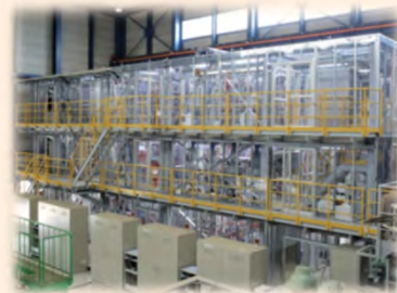
連続水素製造試験装置
